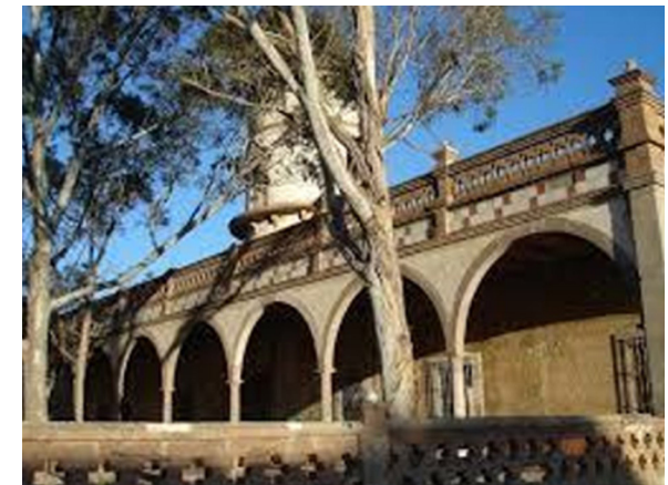
Figura 4. Casa de la hacienda y nave para la producción de mezcal. Propiedad privada, construida a finales del siglo XIX, abandonada y en condiciones de rápido deterioro.
