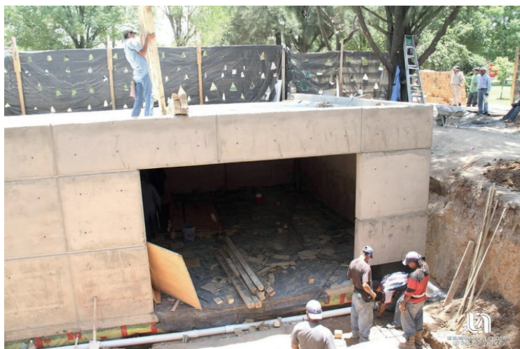
Fototeca UAA. Construcción de la Bóveda “Jesús F. Contreras” en el Campus Central de la UAA, 2012.
