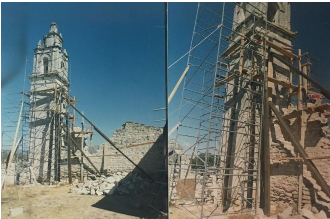
Imagen 10. Sismo Santa María Coacucán 1999, proceso de obra. Foto Archivo Centro INAH Puebla.
